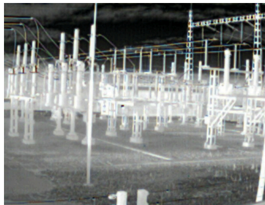
La misma escena vista por una cámara térmica Axis utilizando una paleta ByN.
